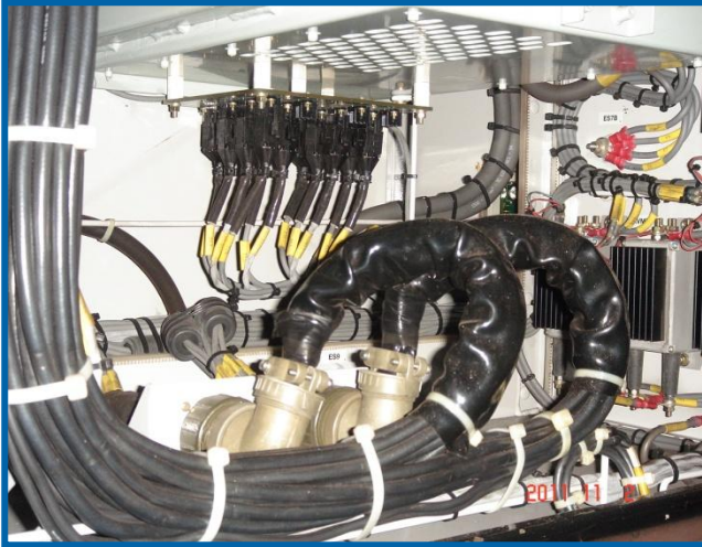
차량 인버터 배면 내부 (콘넥터 부)
